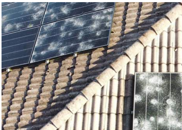
2. Danni all'impianto fotovoltaico
