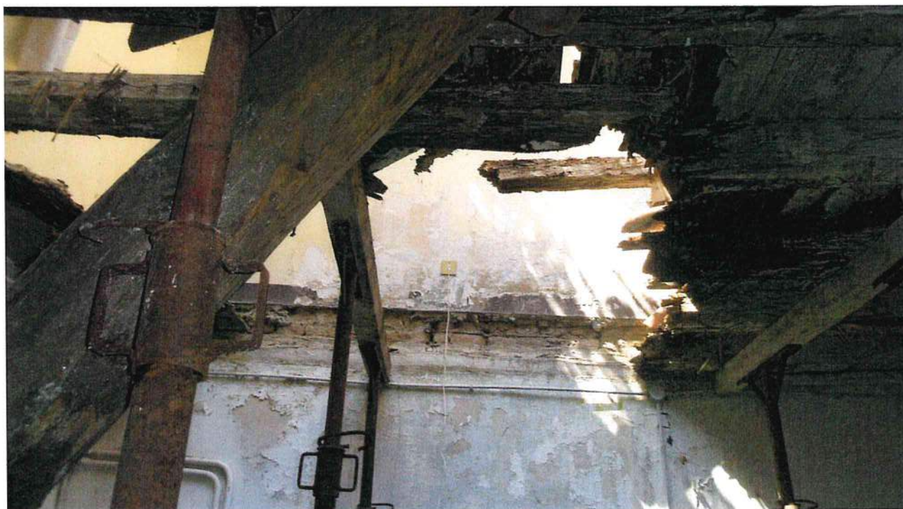
Cedimento di porzione del solaio ligneo del primo impalcato
