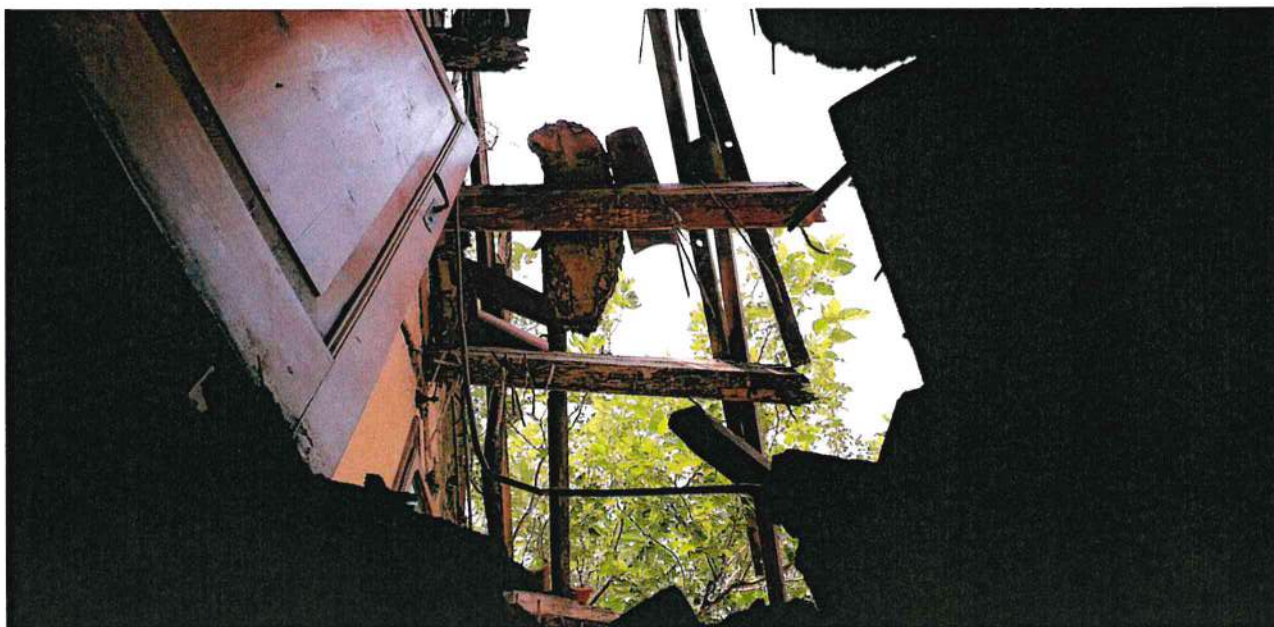
Cedimento di porzione del solaio ligneo della copertura
